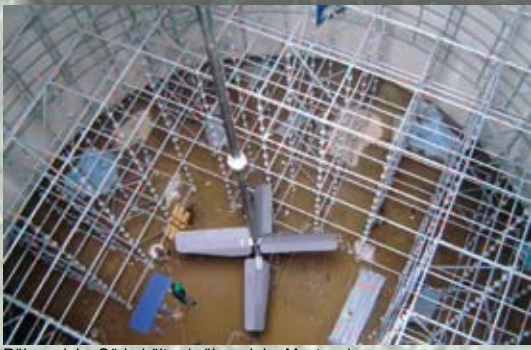
Rührwerk im Gärbehälter (während der Montage)
