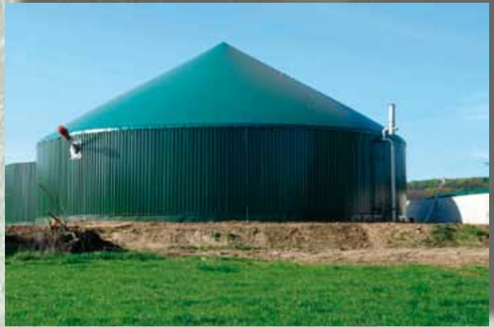
Nachgärbehälter mit Gasspeicherdach
