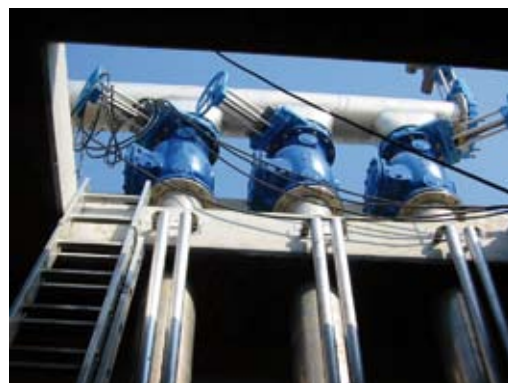
Oczyszczalnia ścieków Büdingen-Düdelnheim Pompy na zbiorniku buforowym
