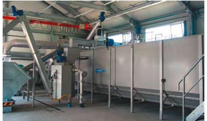
Kraty i piaskownik jako urządzenie kombinowane, Stacja przyjmowania cieków przywożonych wożami asenizacyjnymi (ścieki gromadzone w szambach).
