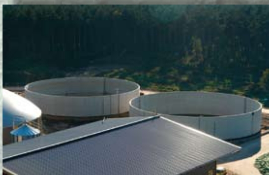
Zbiornik odpadów pofermentacyjnych
